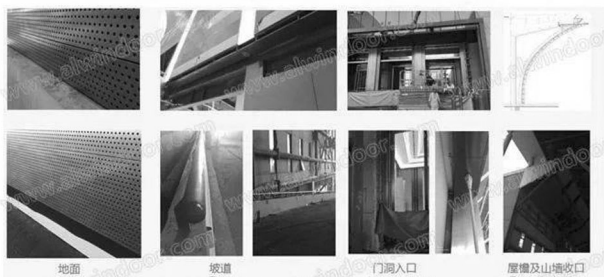
国家会展中心西厅改造项目交接部位的定制加工及安装
